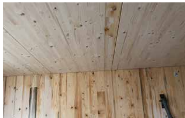
Unschöne Wasserflecken an einer Brettsper Holzdecke
